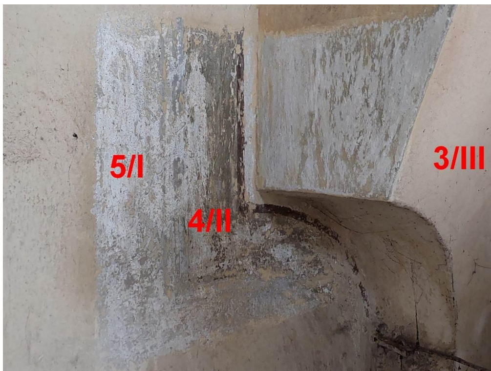
Fot. 11 Lubawka. Kościół p.w. Wniebowzięcia NMP. Sonda usytuowana w dolnym narożniku wspornika. Czerwone oznaczenia odnoszą się do numeracji wynikającej z opracowanej na podstawie badań stratygrafii - patrz tabela 1.
