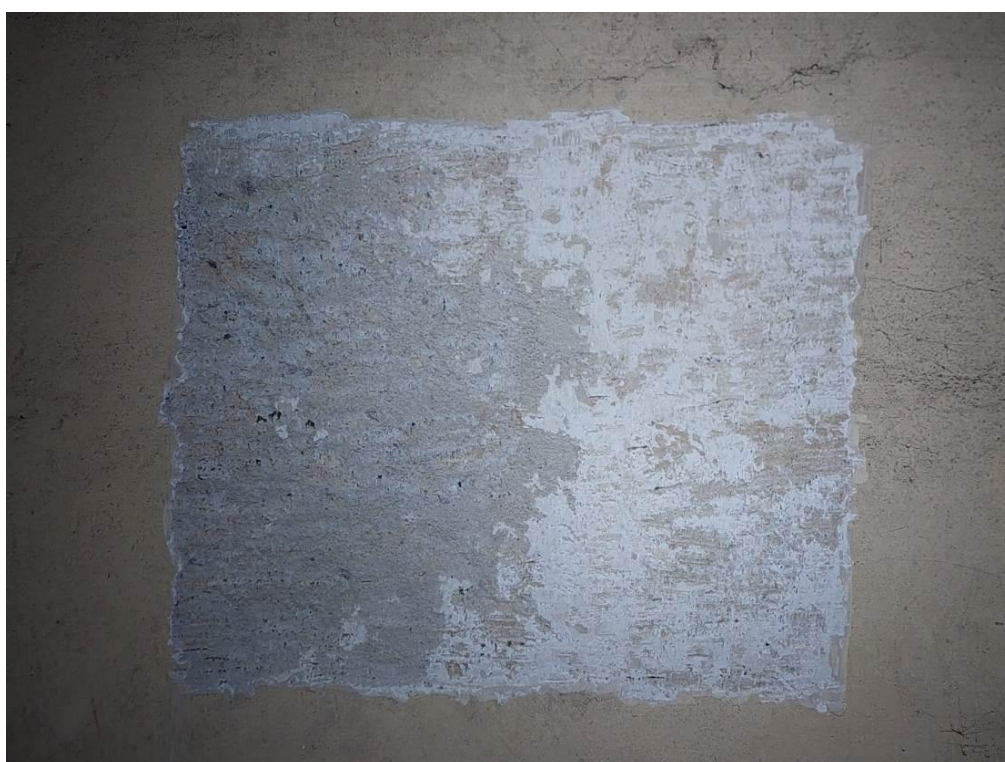
Fot. 3 Lubawka. Kościół p.w. Wniebowzięcia NMP. Sonda usytuowana z lewej strony obrazu wiszącego powyżej północnego wejścia do kościoła. Na sondzie widoczna warstwa tynku (7/I) oraz najstarszych zachowanych pobiał (6/I).
