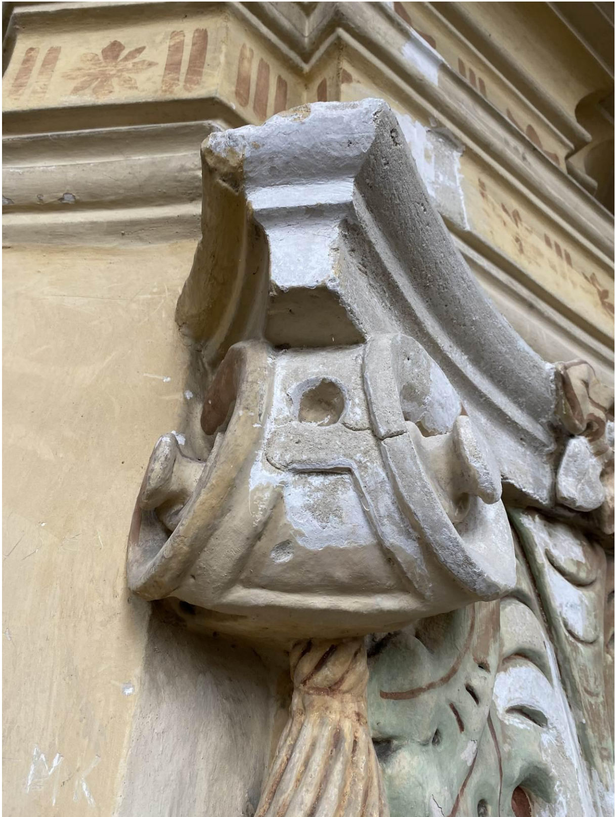
Fot. 19 Lubawka. Kościół p.w. Wniebowzięcia NMP. Sonda usytuowana na jednym z kapiteli pilastrów. Odsłonięta pobiała - najstarsza z warstw występujących na wyprawie narzutu. Widoczny brak zróżnicowania kolorystycznego elementów sztukatorskich. Widoczne szwy na wolicie mogące świadczyć o korzystaniu z fragmentów odlewanych przy wykonywaniu kapiteli.
