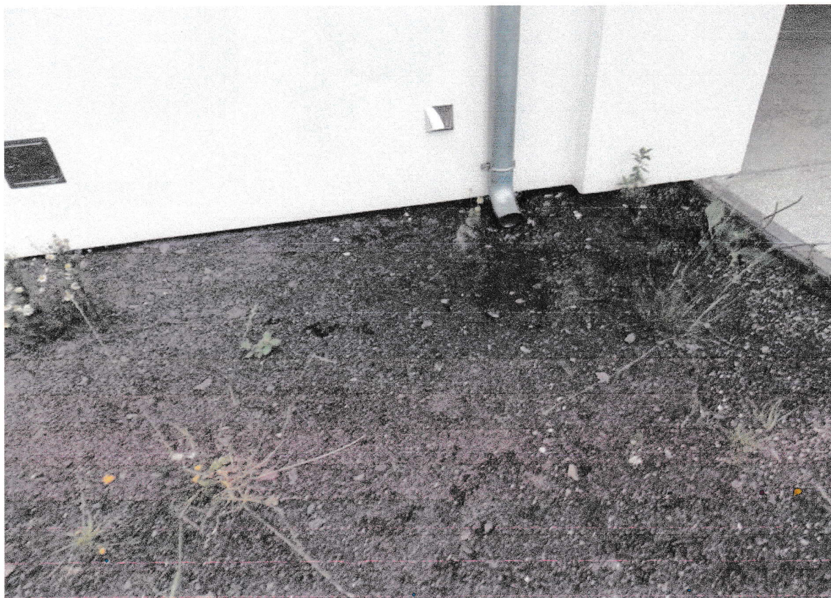
Odpływy rur spustowych rozmywające ścieżkę szutrową
