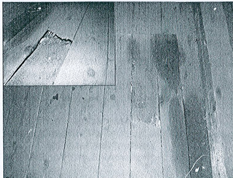
Fot. 2. Pęknięte deskowanie oraz ślady zalewania przez miejscowe nieszczelności w pokryciu.
