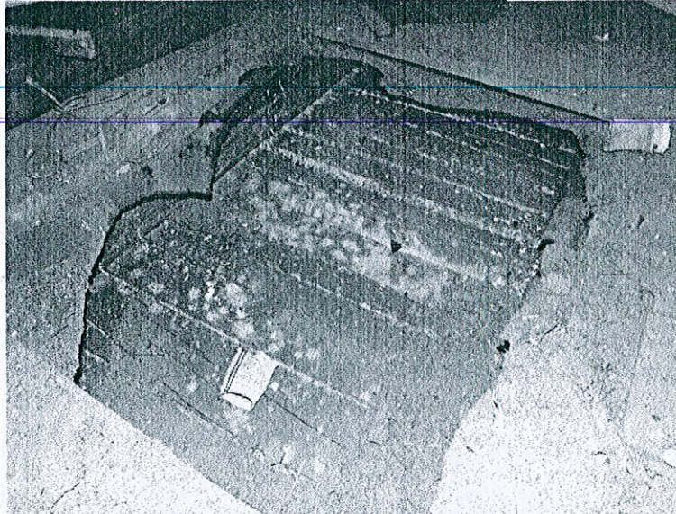
Fot. 1 Zdemontowane deskowanie podłogi, widoczne ślady żerowania owadów
