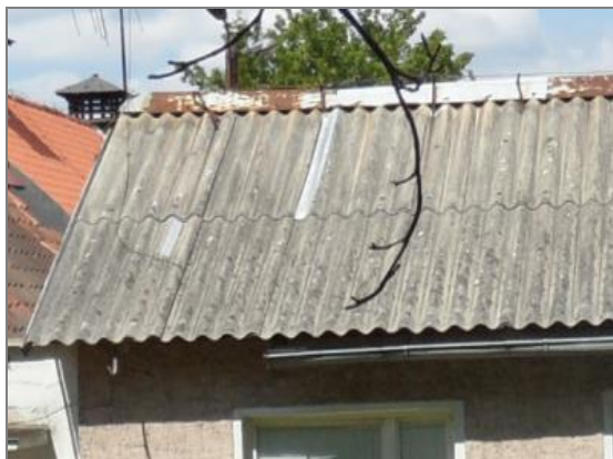
Fot. 1 Płyty azbestowo-cementowe faliste
