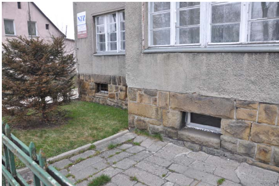
Fot. 7. Widok na elewację frontową . Występują miejscowe pęknięcia na elewacji.
