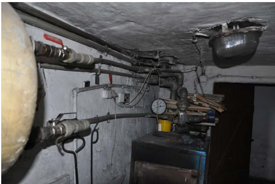
Fot. 13. Kotłownia. Widok na kocioł grzewczy typu „ZIĘBIEC” o mocy 28kW wraz z instalacją
