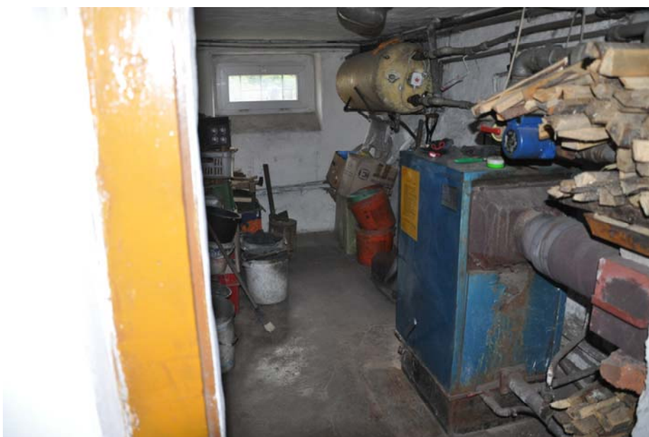
Fot. 14. Kotłownia . Widok ogólny
