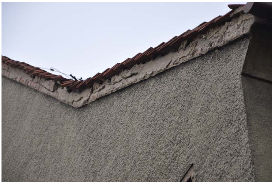
Fot. 35. Widok na wadliwe wykonanie zakończenia pokrycia dachu z ścianą . Brak części okapowej powoduje podciekanie na elewacją oraz osłabienie mocowania dachówek skrajnych które w konsekwencji wypadają.
