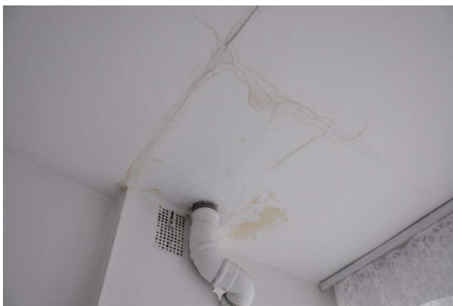
Fot. 24. Piętro I. Pom. nr 22 – WC . Widok na zacieki na stropie spowodowane nieuszczelnnością pionu instalacji kanalizacyjnej.
