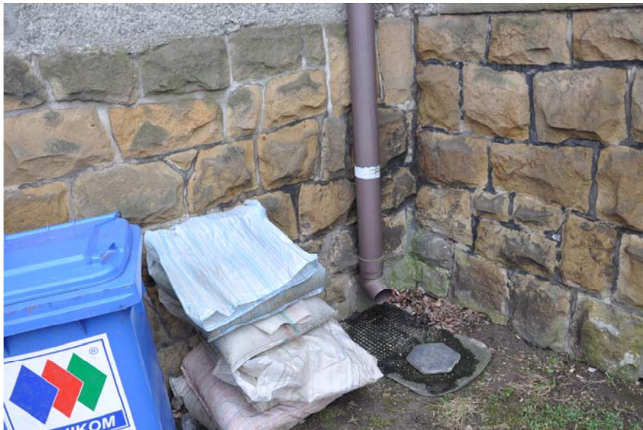
Fot. 5. Widok na ściany przyziemia obłożone płytką kamienną z piaskowca. Brak opaski z warstwą odwadniającą
