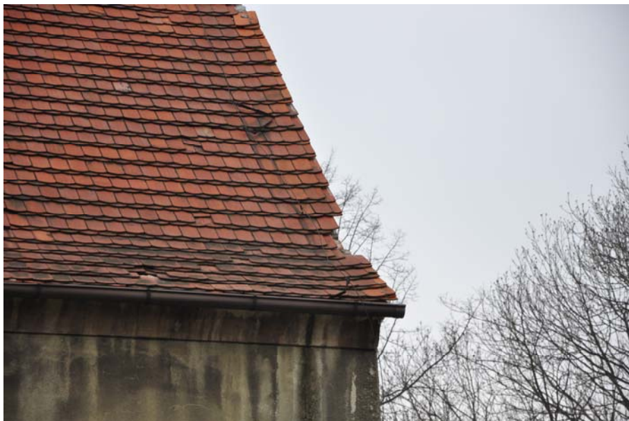
Fot. 33. Widok na pokrycie dachowe .Liczne ubytki dachówek skrajnych pokrycia oraz zły stan instalacji odgromowej .
