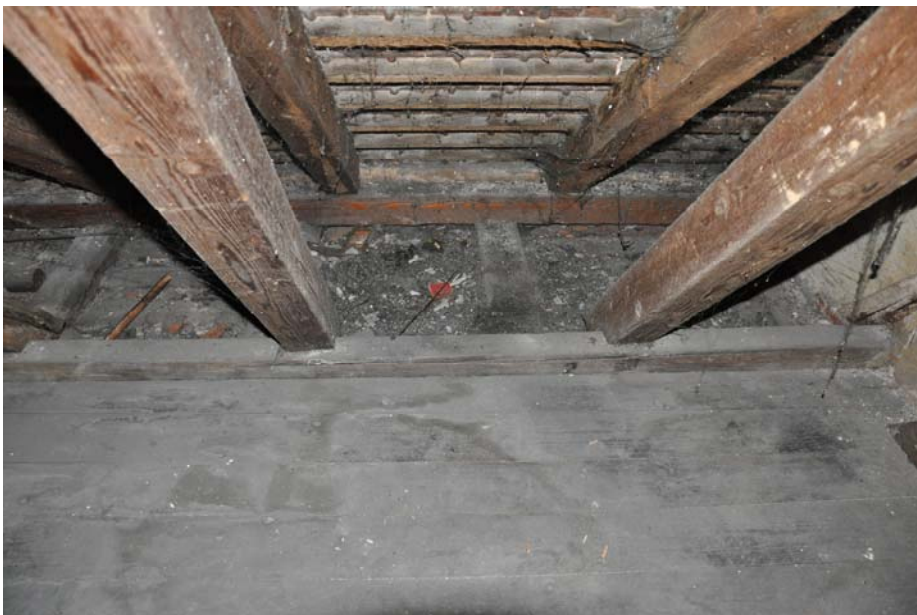
Fot.25. Poddasze użytkowe . Pomieszczenie gospodarcze . Widok na część przypodłogową i konstrukcję dachu.
