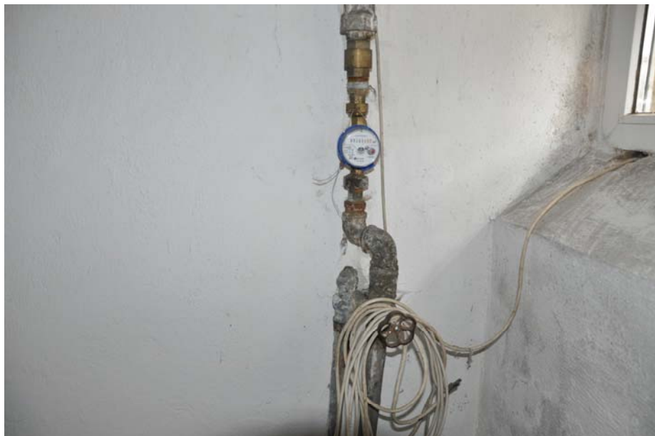
Fot. 17. Piwnica. Pomieszczenie przyłącza wody.
