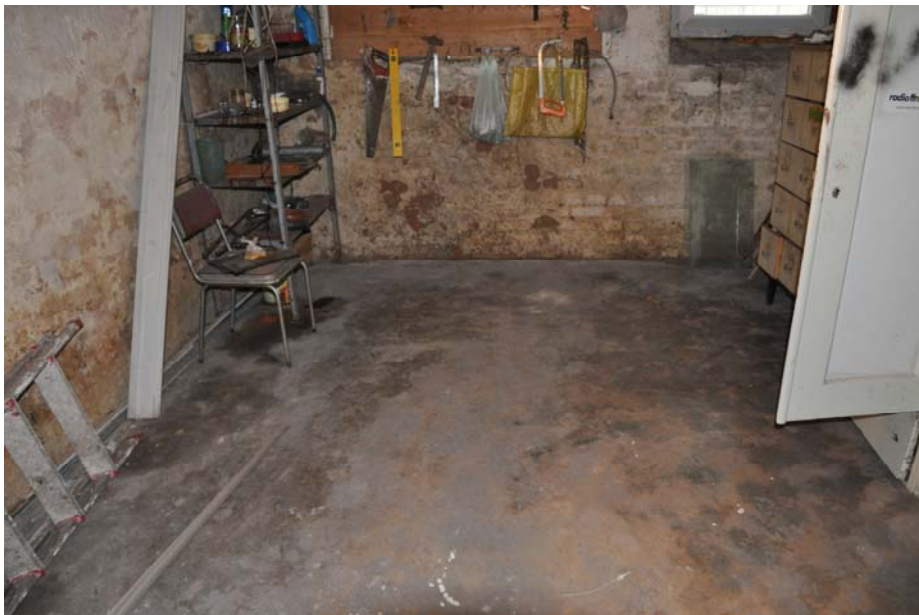
Fot.16. Piwnica pom. nr 07. Widok na zawilgocone sciany.
