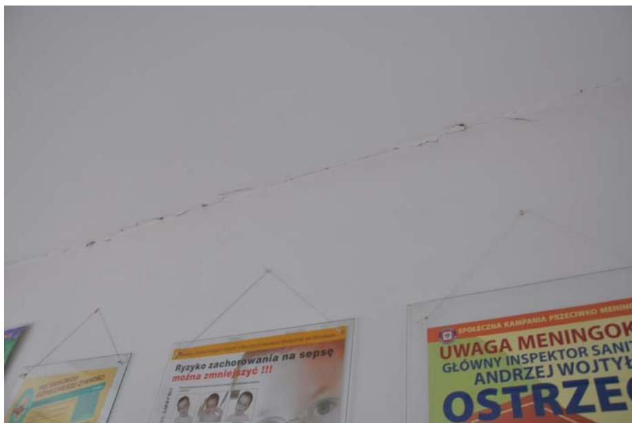
Fot. 21. Piętro I .Pom. 24. Widoczne spękania tynku na połączeniu ściany zewnętrznej i stropu . Stan niezadowolający .
