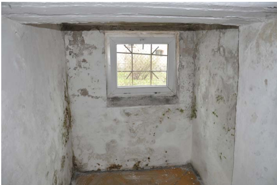
Fot.11. Pomieszczenie piwniczne nr 03. Widoczne zawilgocenia na ścianie zewnętrznej i ścianach wewnętrznych działowych
