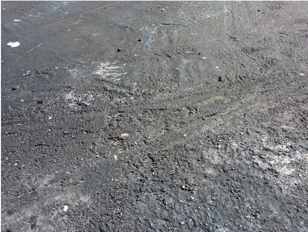
Fot. 7. Miejscowe nierówności szlichty cementowej
