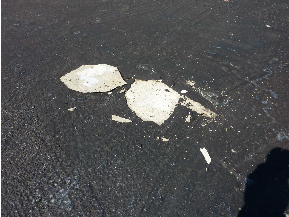
Fot. 5. Widoczna łuszcząca się i spękana szlichta cementowa
