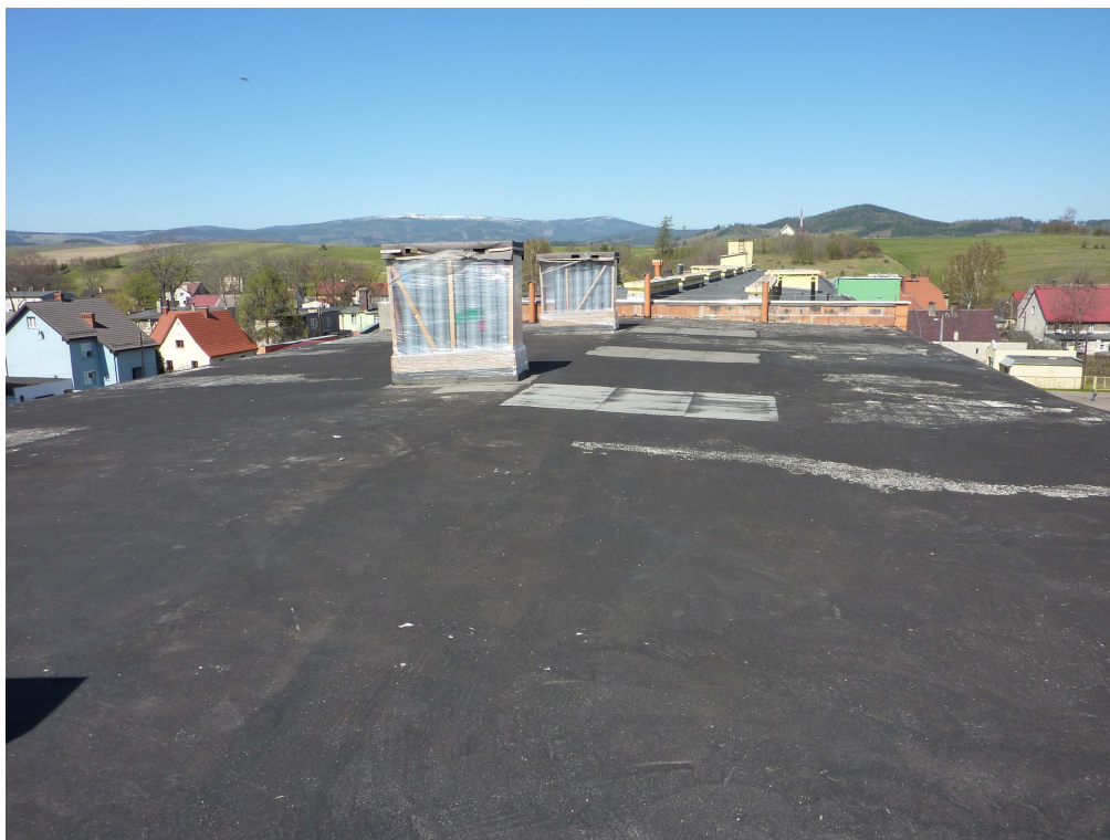
Fot. 1. Widoczne miejsca wyłukanej powłoki bitumicznej
