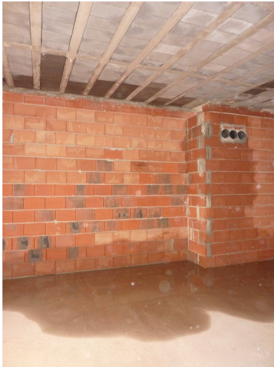
Fot. 8. Widoczna przecieki wodą opadową przez stropodach i komin wentylacyjny
