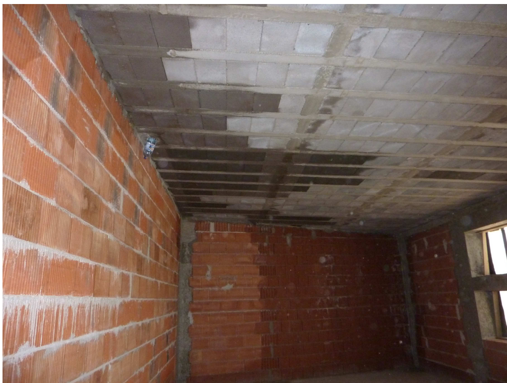
Fot. 9. Widoczne zacieki wodą opadową na stropie i ścianie
