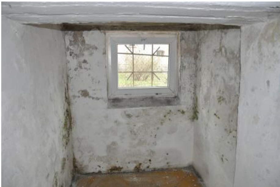
Fot.11. Pomieszczenie piwniczne nr 03. Widoczne zawilgocenia na ścianie zewnętrznej i ścianach wewnętrznych działowych
