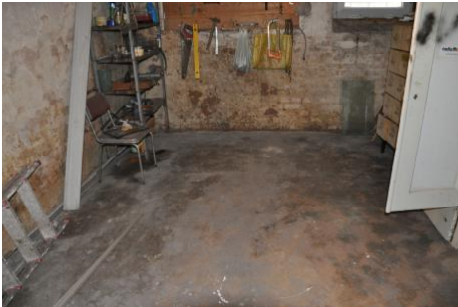
Fot.16. Piwnica pom. nr 07. Widok na zawilgocone ściany.
