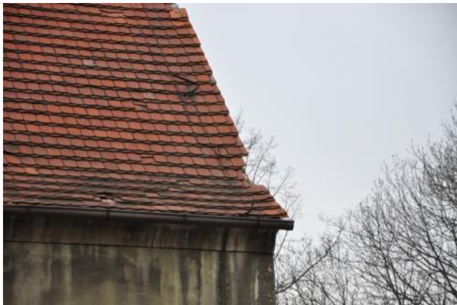
Fot. 33. Widok na pokrycie dachowe .Liczne ubytki dachówek skrajnych pokrycia oraz zły stan instalacji odgromowej .
