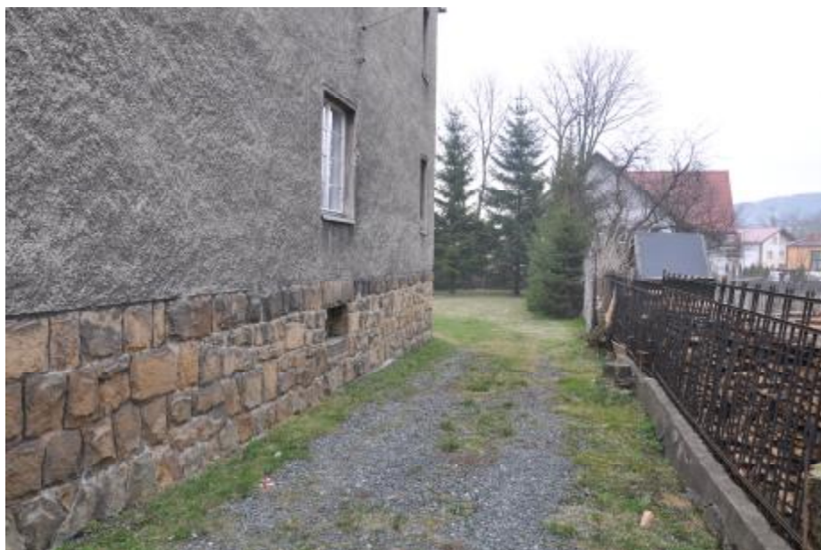
Fot. 6. Elewacja boczna wraz z przyziemiem . Brak opaski i warstwy dwadniającej.
