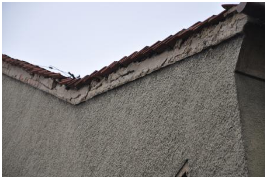
Fot. 35. Widok na wadliwe wykonanie zakończenia pokrycia dachu z ścianą . Brak części okapowej powoduje podciekanie na elewację oraz osłabienie mocowania dachówek skrajnych które w konsekwencji wypadają.
