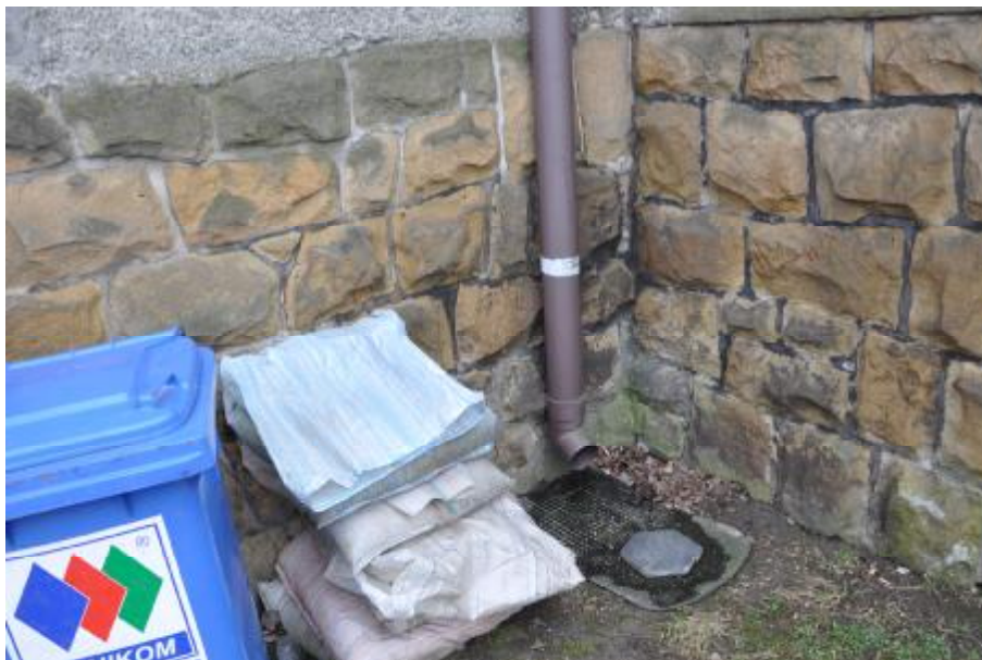
Fot. 5. Widok na ściany przyziemia obłożone płytką kamienną z piaskowca. Brak opaski z warstwą odwadniającą
