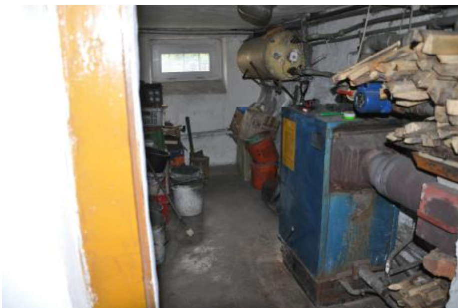
Fot. 14. Kotłownia . Widok ogólny
