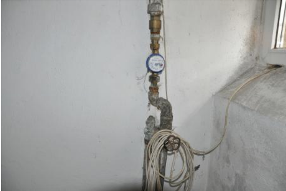
Fot. 17. Piwnica. Pomieszczenie przyłącza wody.
