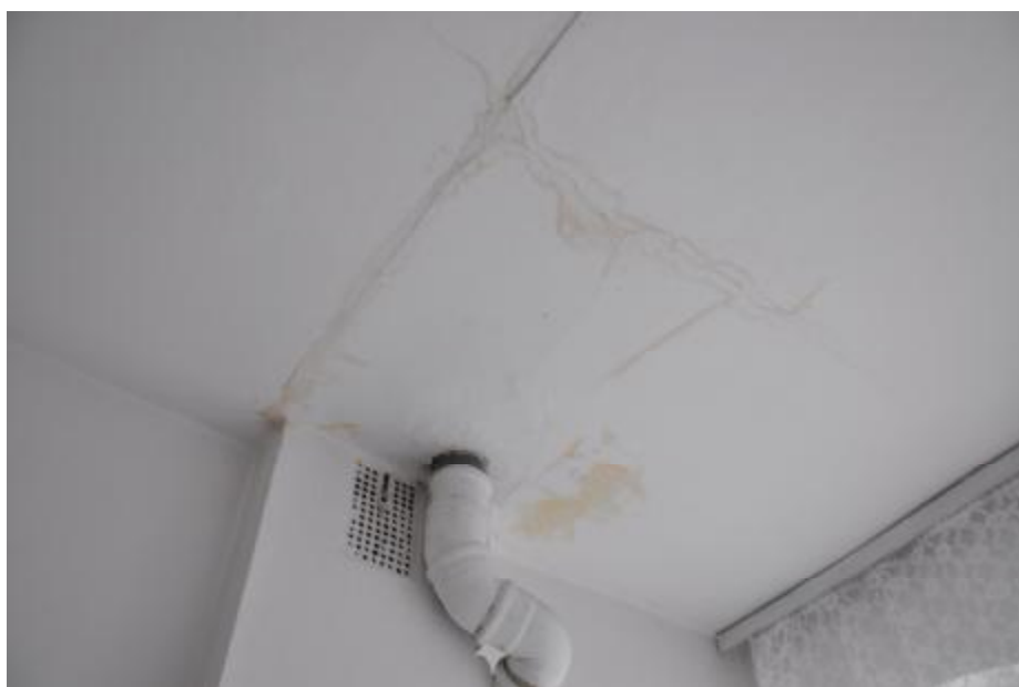
Fot. 24. Piętro I. Pom. nr 22 – WC . Widok na zacieki na stropie spowodowane nieszczelnością pionu instalacji kanalizacyjnej.
