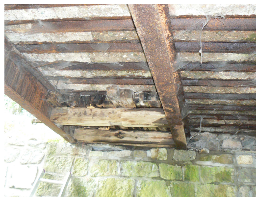
Fot.11 Doraźna naprawa płyty w miejscu załamania
