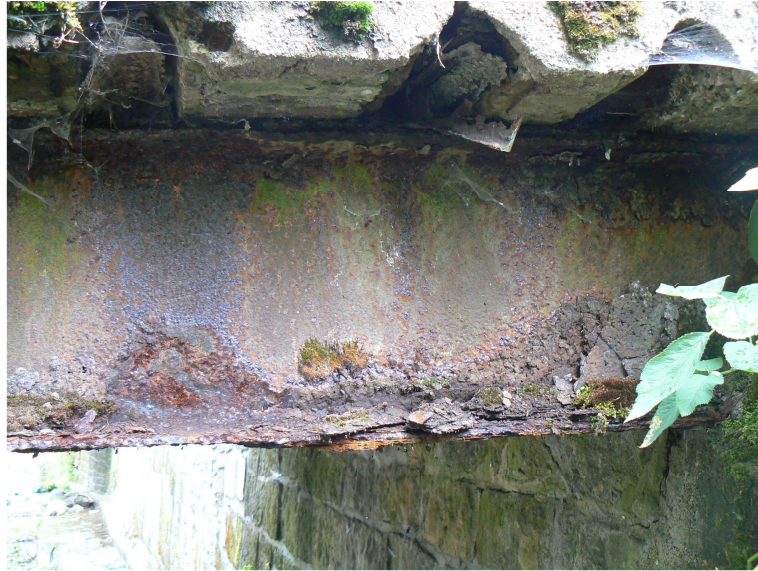
Fot. 7 Uszkodzenie belki IN320 od strony góry rzeki w strefie przypodporowej Ubytki korozyjne w granicach 65 % Brak kształtowników nośnych pomostu (100% zużycia korozyjnego). Przyczyną uszkodzenia jest brak izolacji i właściwego odwodnienia pomostu, jak również brak właściwego utrzymania obiektu.
