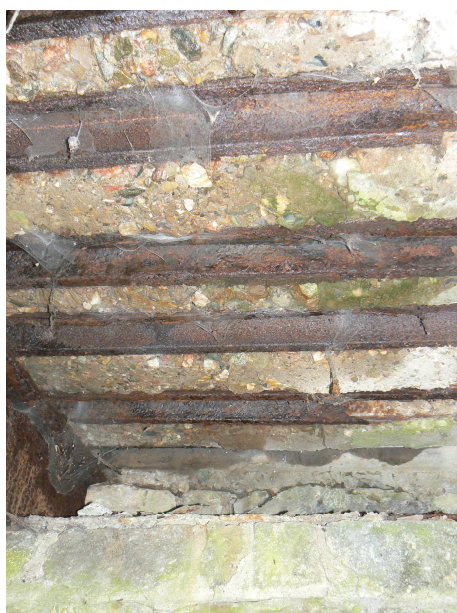
Fot.10 Pęknięta płyta pomostu w strefie przypodporowej od strony drogi głównej. Utrata nośności płyty spowodowana przez zniszczenie kształtowników nośnych
