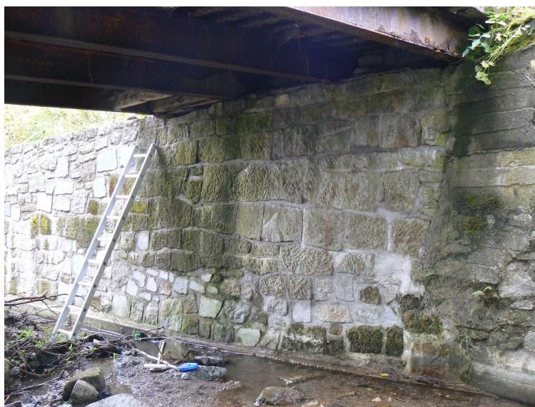
Fot.4 Przyczółek kamienny w ciągu muru oporowego rzeki od strony drogi głównej. Zawilgocenia i wegetacja mchów spowodowane brakiem skutecznej izolacji pomostu i właściwego odwodnienia.
