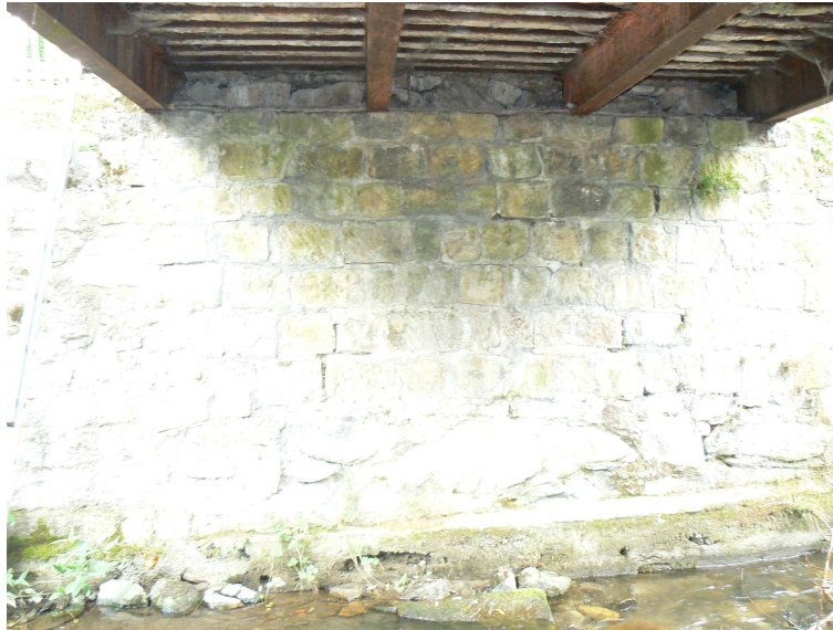
Fot.5 Przyczółek kamienny w ciągu muru oporowego rzeki od strony bud. nr 34 Zawilgocenia i wegetacja mchów spowodowane brakiem skutecznej izolacji pomostu i właściwego odwodnienia . Lokalne ubytki spoinowania i odsłonięte raki betonu opaski przynurkowej spowodowane działaniem górskiej rzeki. Główna konstrukcja nośna wykonana z 4szt. IN320. Konstrukcja pomostu betonowa z betonu grubo frakcyjnego, monolityczna, na kształtownikach stalowych typu Zoresa) ułożonych ażurowo. Brak wykształconego łóżyska pomostu.
