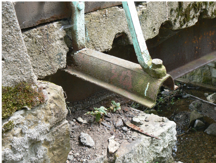
Fot.6 Przedłużony wspornikowo profil stalowy pomostu z przymocowaną konstrukcją barierki zabezpieczającej. Całkowite zniszczenie korozyjne przekroju profilu nośnego na styku z licem pomostu
