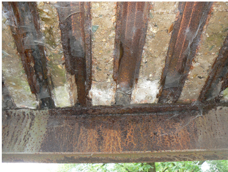
Fot. 8 Uszkodzenie belki IN320 od strony góry rzeki w strefie środkowej przęsła Ubytki korozyjne w granicach 65 % Brak kształtowników nośnych pomostu (100% zużycia korozyjnego). Przecieki wody przez płytę. Przyczyny uszkodzenia j.w.
