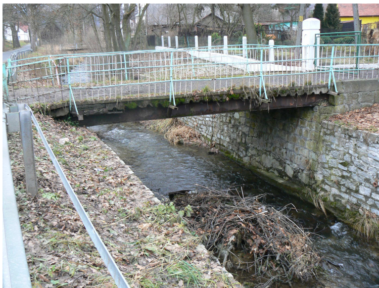
Fot.1 Widok ogólny mostu od strony dołu rzeki Żłoty Potok. Zanieczyszczenia przestrzeni podmostowej i koryta rzeki. Wegetacja roślin w obrębie dojazdów .
