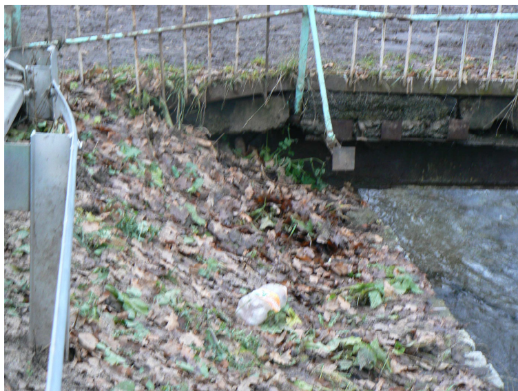
Fot. 9 Uszkodzenie belki IN320 od strony dołu rzeki w strefie przypodporowej przęsła Ubytki korozyjne w granicach 65 % Niewłaściwa naprawa uszkodzonej (załamanej) płyty pomostu w strefie najazdu na most. Przyczyny uszkodzenia j.w.
