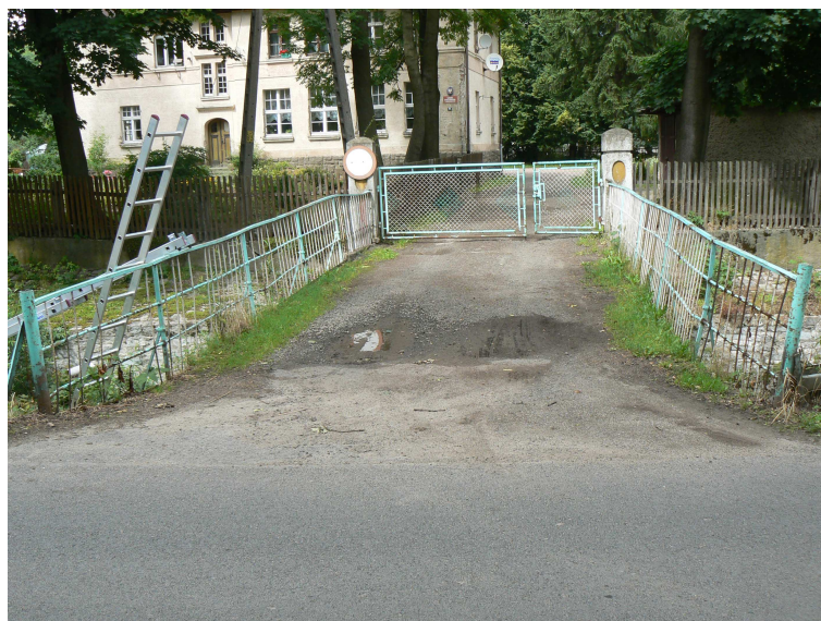
Fot.3 Widok mostu od strony drogi głównej. Zastoiska wody opadowej na płycie pomostu spowodowane brakiem właściwych spadków i zanieczyszczeniem płyty . Wegetacja roślin i zanieczyszczenia powierzchni, deformacja barierek zabezpieczających.
