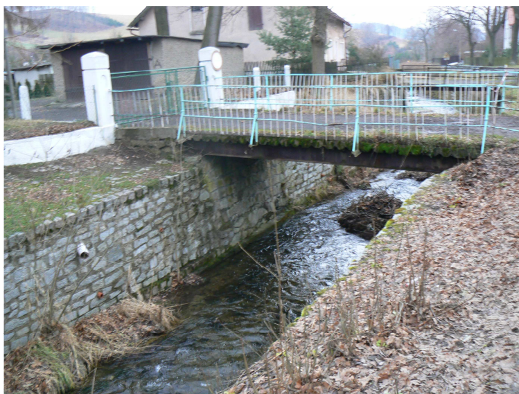
Fot.2 Widok ogólny mostu od strony góry rzeki Żłotna. Zanieczyszczenia przestrzeni podmostowej i koryta rzeki.
